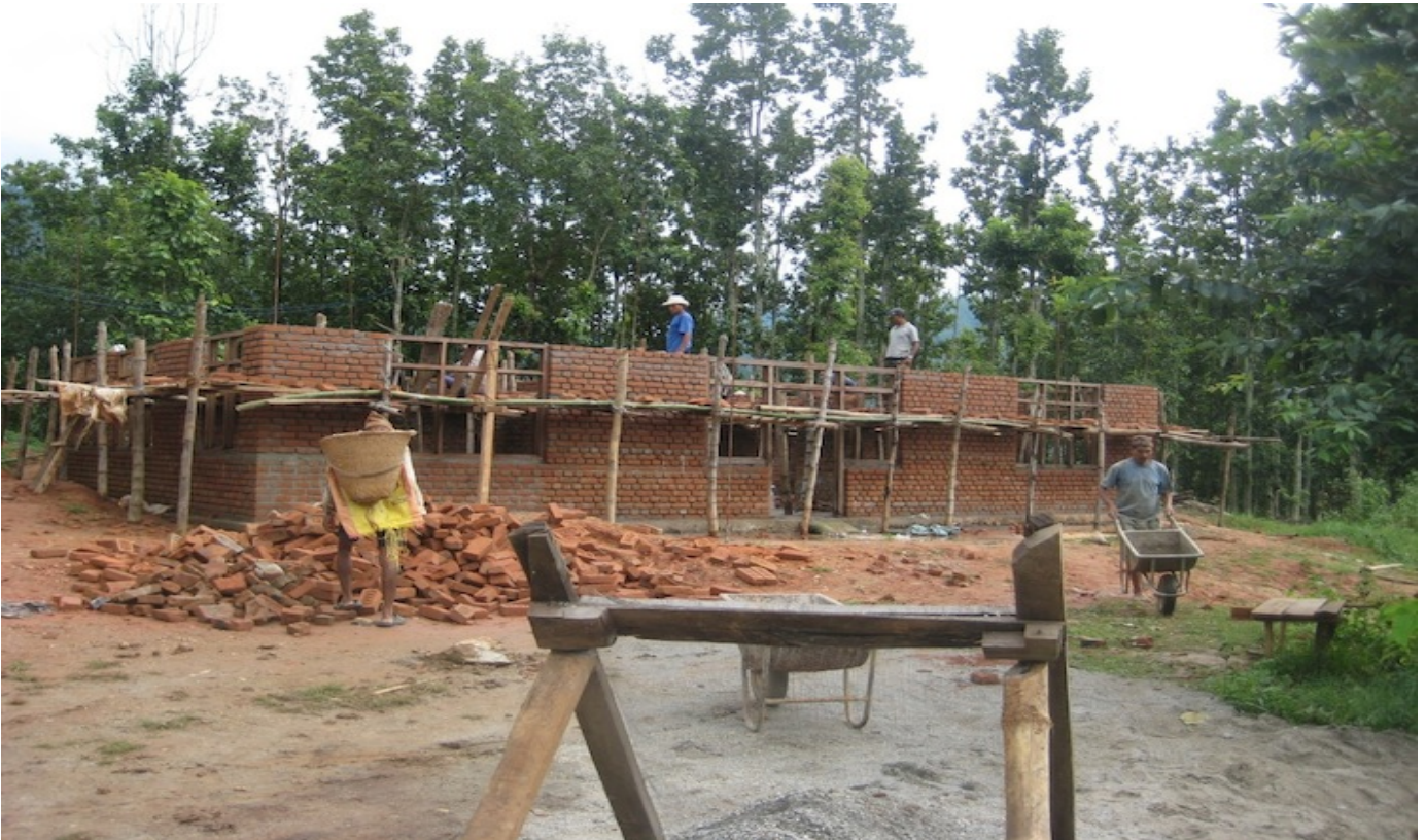
Arbeiten am Haus Nr. 5. Die ersten 3 Häuser haben bereits ein Dach. Bei den Häusern 4 und 5 stehen die Wände, die Dächer werden in den nächsten Tagen betoniert.
